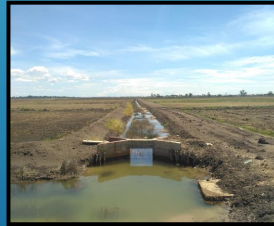
Pintu Air Stop Lock
