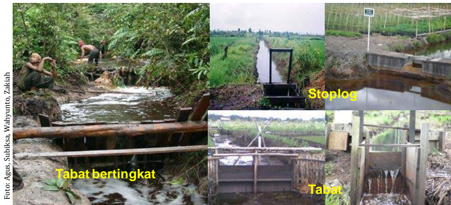
Gambar 15. Pintu air pada saluran drainase, yang berfungsi untuk mengatur tinggi muka air di saluran dan muka air tanah di lahan gambut
