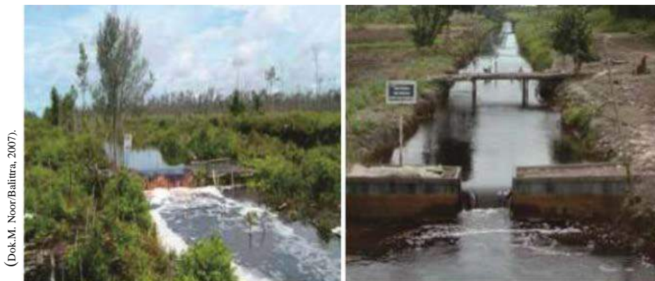
Gambar 6. Pintu tabat dalam pengelolaan air di lahan gambut Lamunti, Kabupaten Kapuas, Kalimantan Tengah
