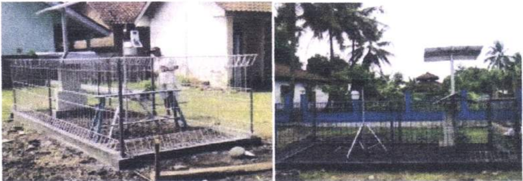
Gambar 32. Instalasi Hardware di Daerah irigasi Tajum
