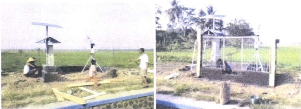
Gambar 31. Instalasi Hardware di Daerah irigasi Boro
